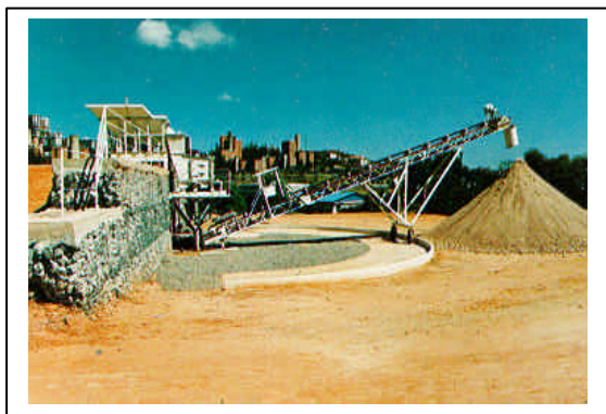
Foto 21 - Usina de Reciclagem de Entulhos
