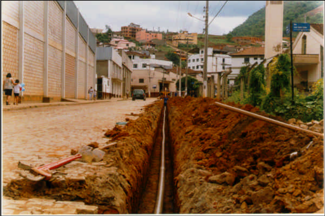
Foto 6 - Rede de Distribuição em PVC PBA
