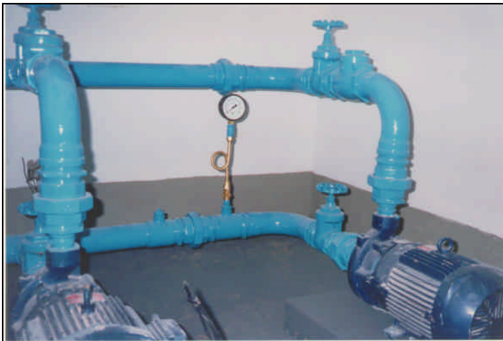
Foto 7 - Estação Elevatória de Água Tratada
